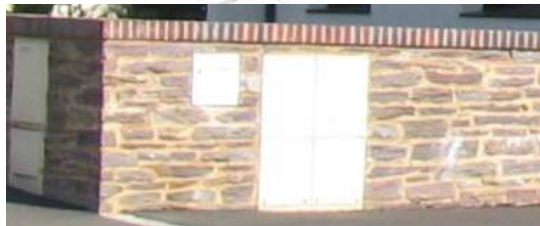
Coffrets intégrés dans le retour de mur
